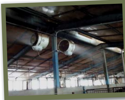
5. ábra Magas légterű épület hűtése párasító ventilátorral
